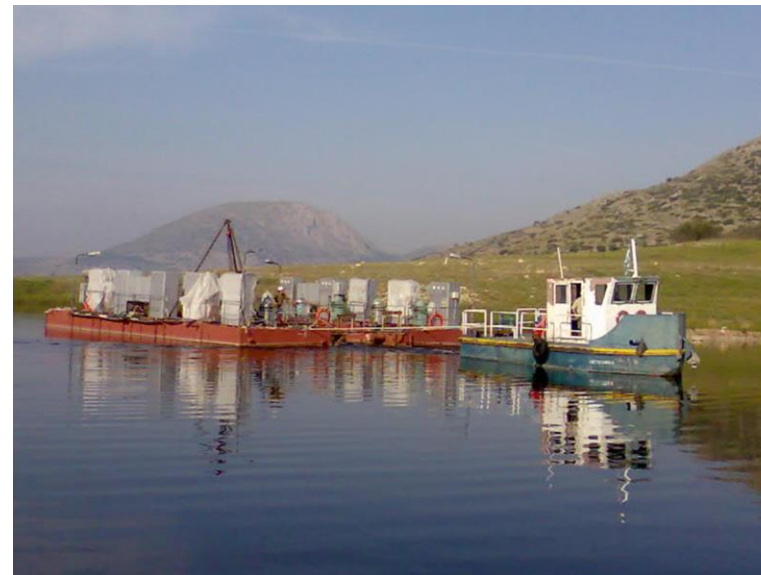
Πλωτά Αντλιοστάσια στην Υλίκη
